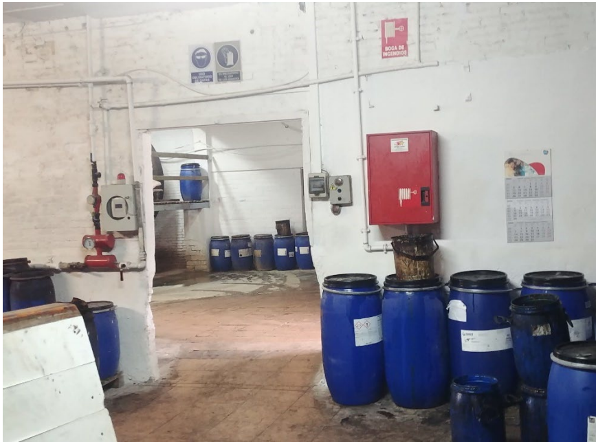
**Fotografía Aqualata: boca de incendios y señalizaciones de EPI's
